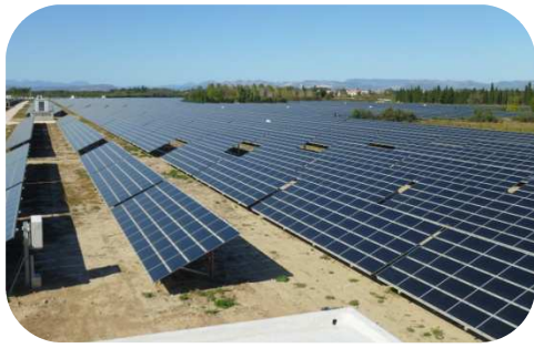
Figure 5: Centrale Solaire de Toreilles (12 MWc)
