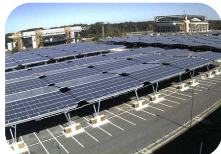
Figure 4 : Centrale Solaire de Pau (3,3 MWc)
