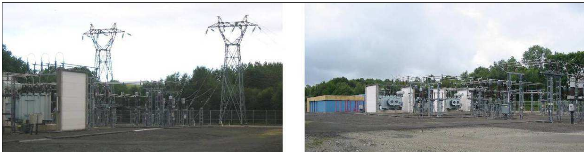
Figure 29 : Poste source de Plémy- Source : EED/POWEO ENR
