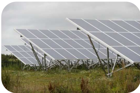
Figure 3: Centrale au sol de Lannion (2,6 MWc)
