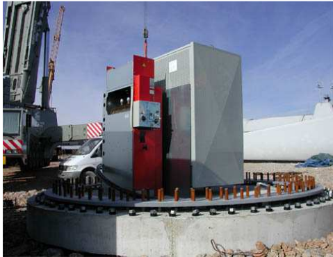
Figure 25 : Mise en place de l'équipement électrique sur le site de Fitou – Source : Cegelec
